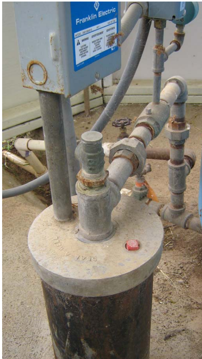
Foto: Ilustra la tubería de revestimiento, su cubierta y el sistema de conducción de un pozo domestico. El pozo se encuentra localizado dentro de un cobertizo con piso de concreto.
